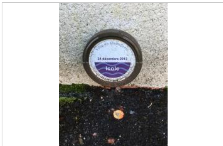
repère de décembre 2013 à l'angle du bâtiment place des anciennes fonderies
