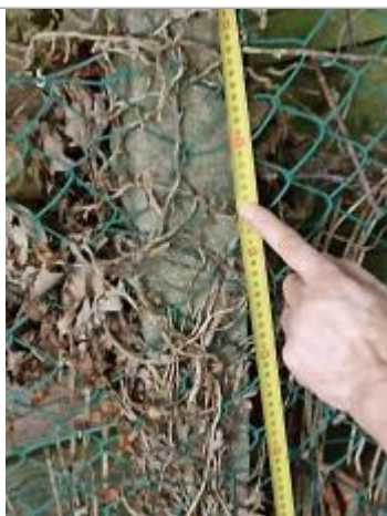
Laisse de crue à 75 cm/sol
