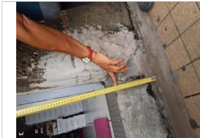
Témoignage sur l'hauteur atteint par l'eau (valeur approximative)
