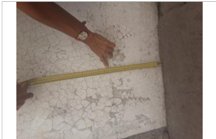
Dépôt de matières solides
