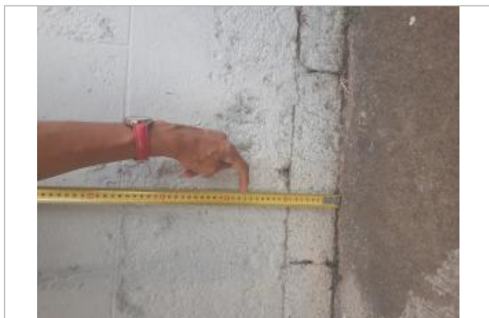
Hauteur atteinte par l'inondation d'après le témoignage
