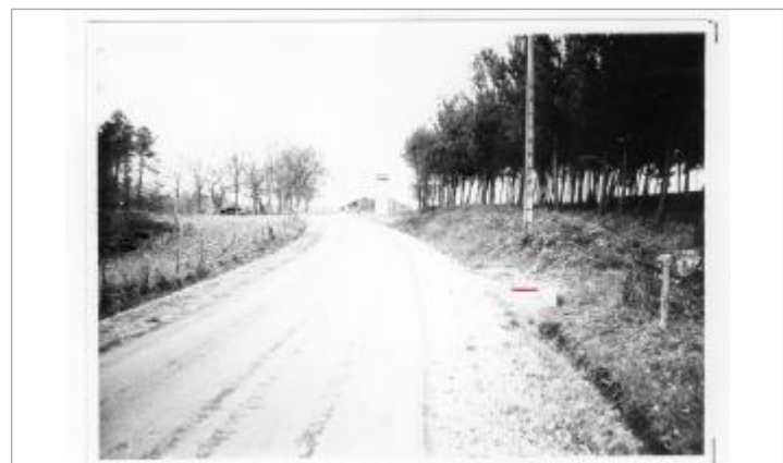
5 - Voie communale n° 3 - Aqueduc à côté du cimetière de CARCEN (confluence du réseau de Moyze)
