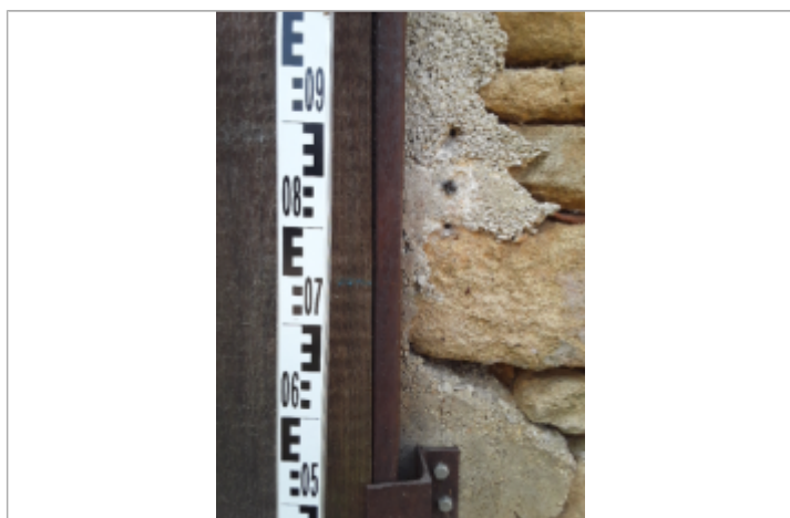
photo du repère de près
