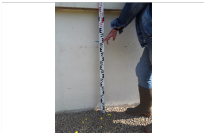
photo du repère de près
