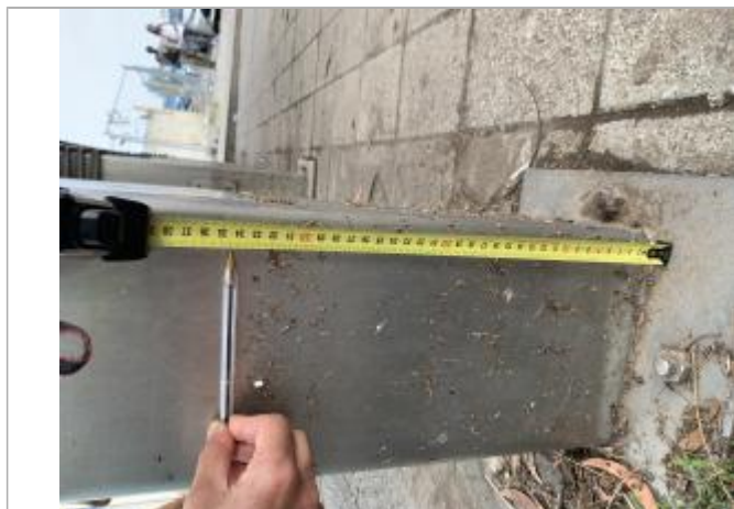
Dépôt de matières solides
