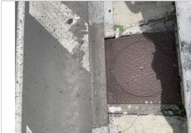
Emprise de la zone inondée au niveau de la bouche d'égout
