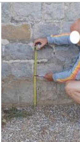
Laisse de crue à 30 cm/sol.
