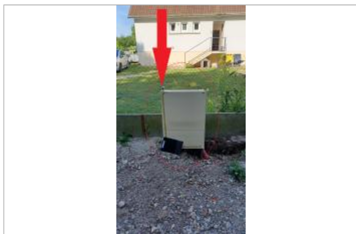
Laisse de crue à 54 cm/sol.
