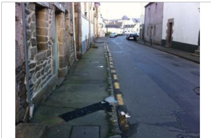
Trottoir 42 RUE DES MOULINS
