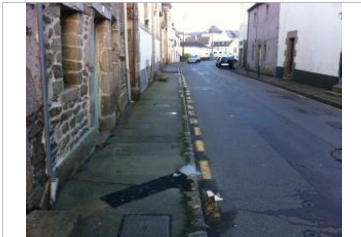
Trottoir 42 RUE DES MOULINS
