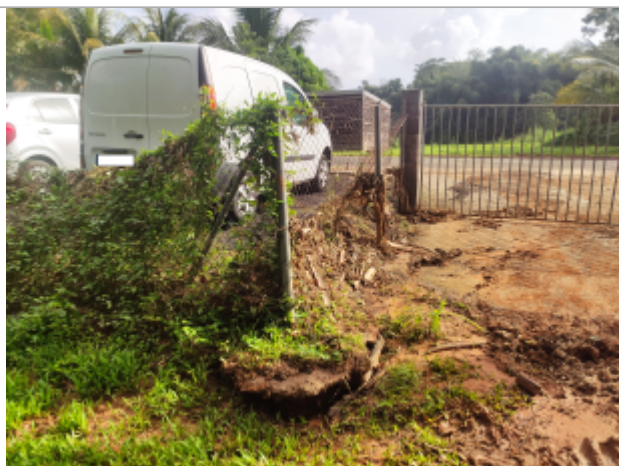
Dépôts de matières solides
