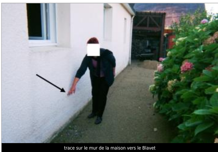
trace sur le mur de la maison vers le Blavet
