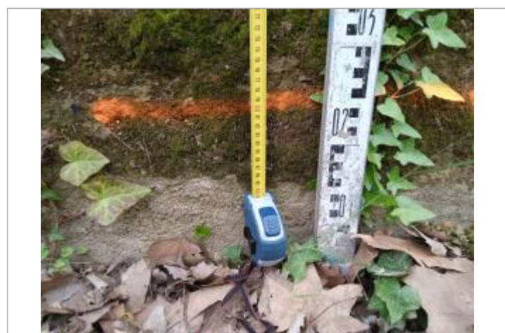
Trace sur la culée
