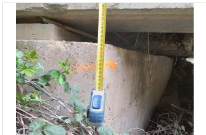
Trace sur la culée
