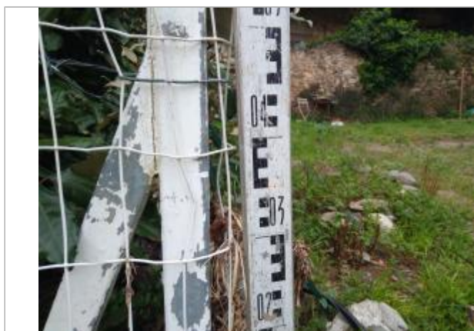
Débris végétaux dans le grillage
