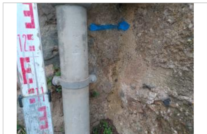
Trace sur le mur
