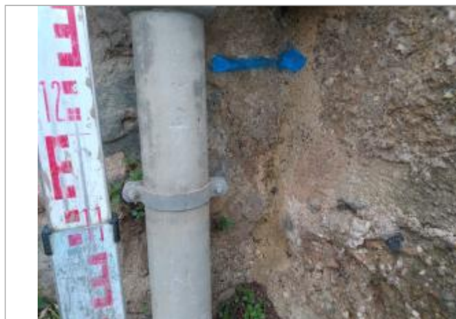
Trace sur le mur
