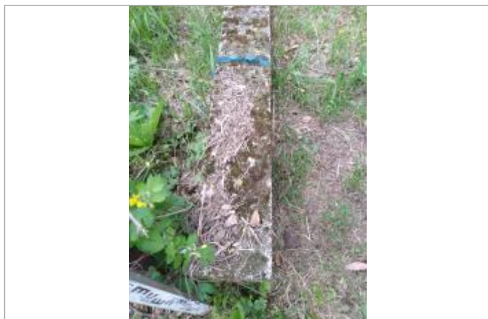
Dépôt sur le muret
