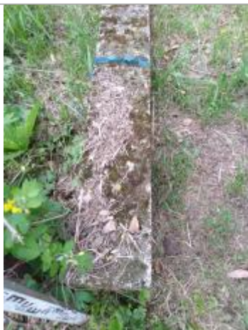
Dépôt sur le muret
