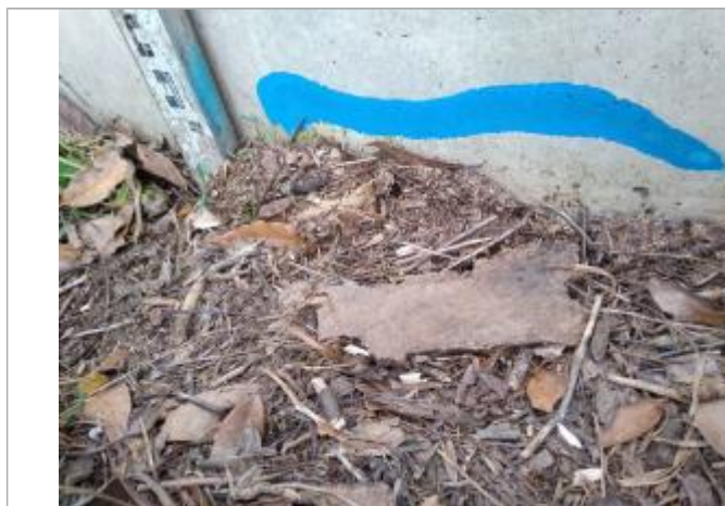
Dépôt contre le massif en béton
