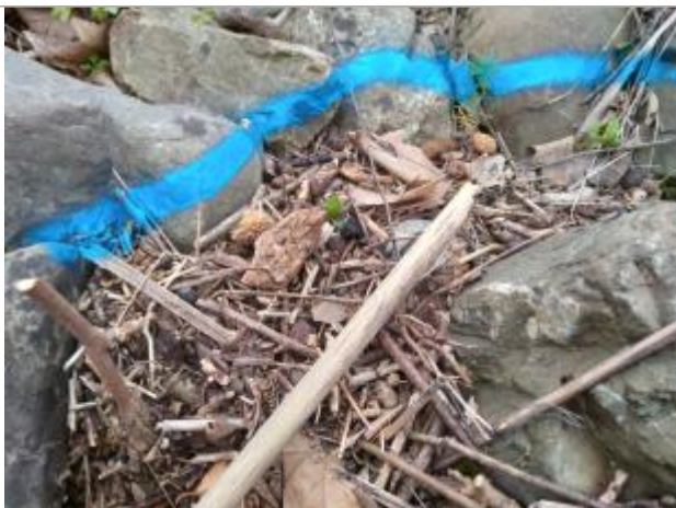
Dépôt sur les gabions
