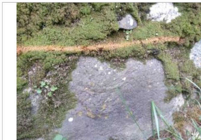
Trace sur le mur
