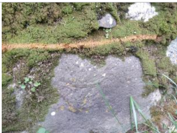
Trace sur le mur
