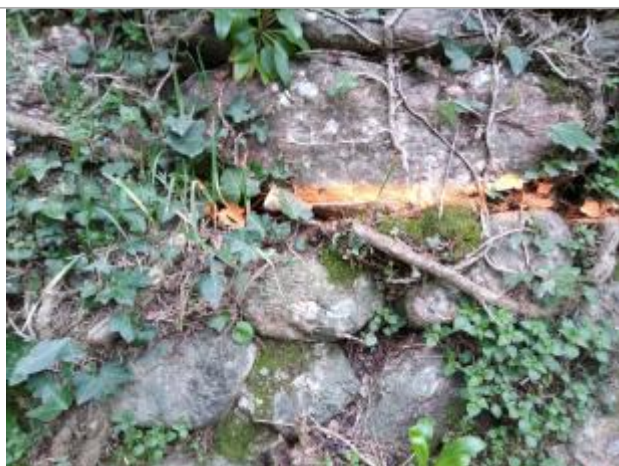
Trace sur le mur
