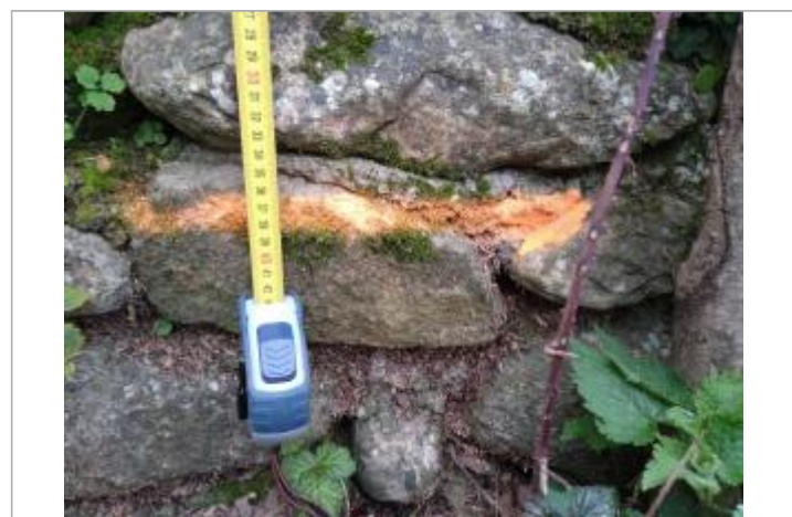
Trace sur le muret
