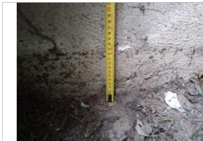
Trace dans le local - 1m02 sous la marque de 2014
