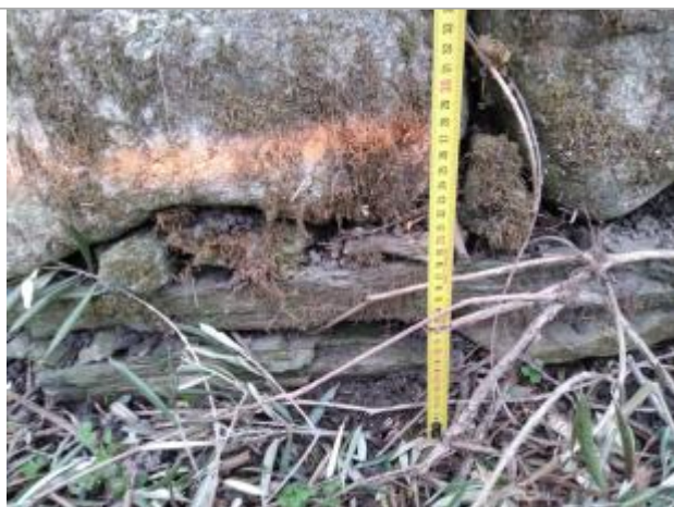
Trace sur le mur
