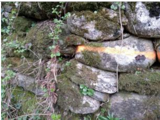
Trace sur le mur
