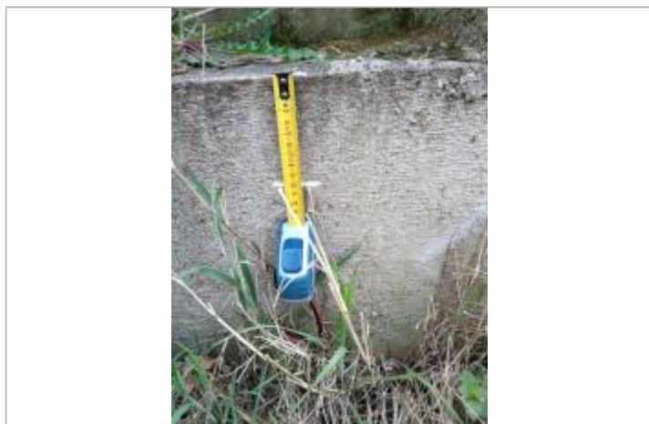
Trace sur l'ouvrage
