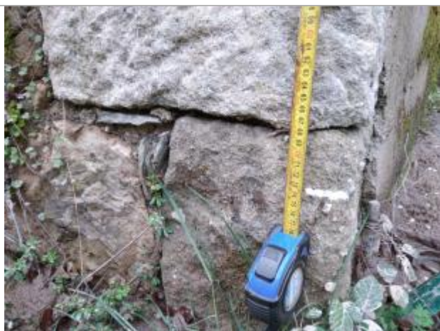
Trace sur le mur
