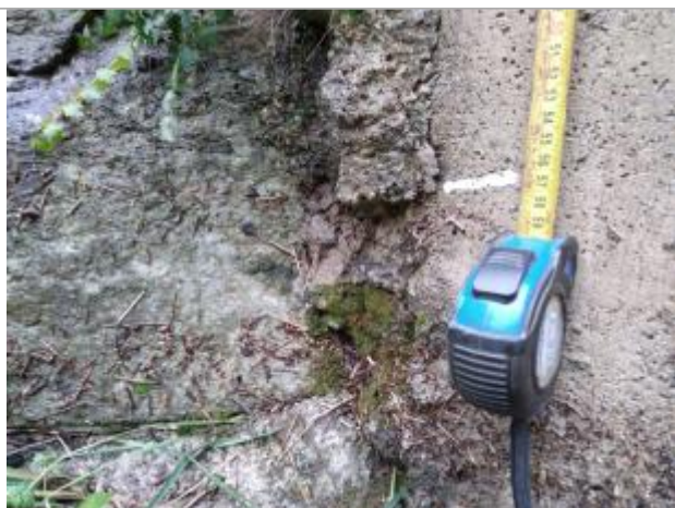
Trace sur le ponceau
