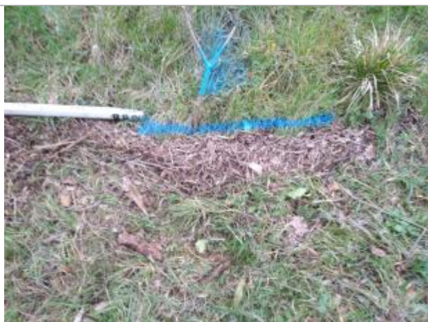
Dépôt en pied de talus
