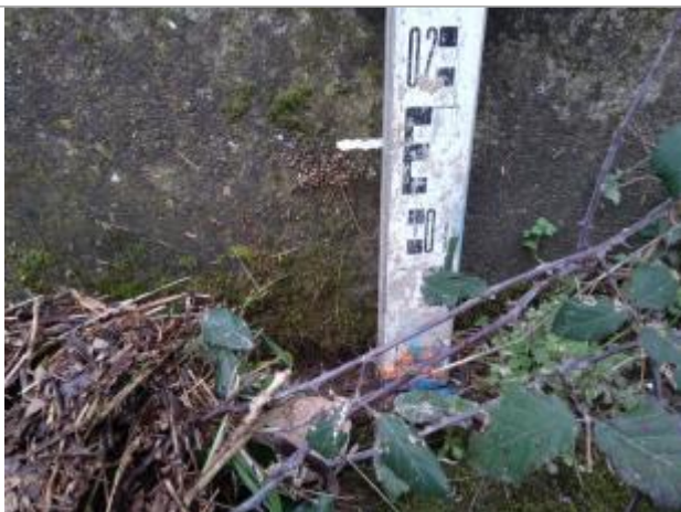
Trace sur le mur
