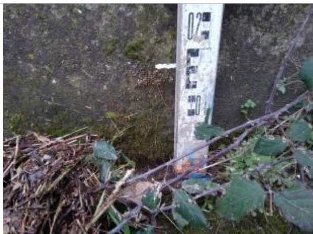
Trace sur le mur
