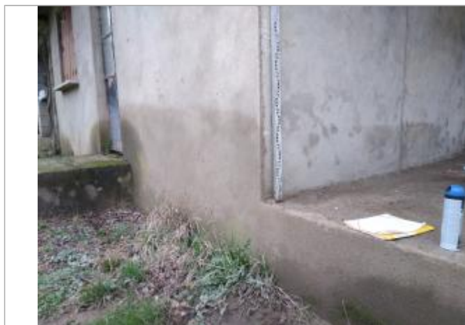
Trace sur le mur
