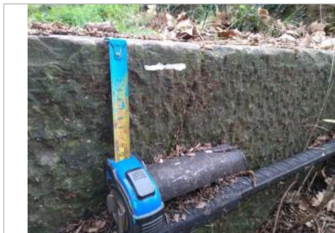
Trace sur l'ouvrage
