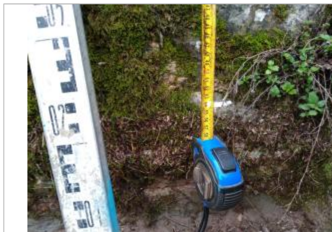
Trace sur le mur
