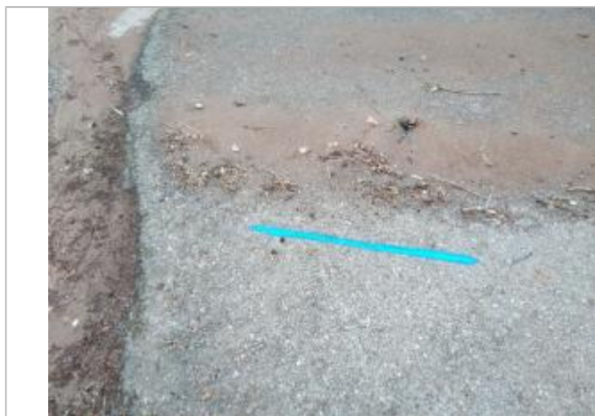
Dépôt sur la chaussée
