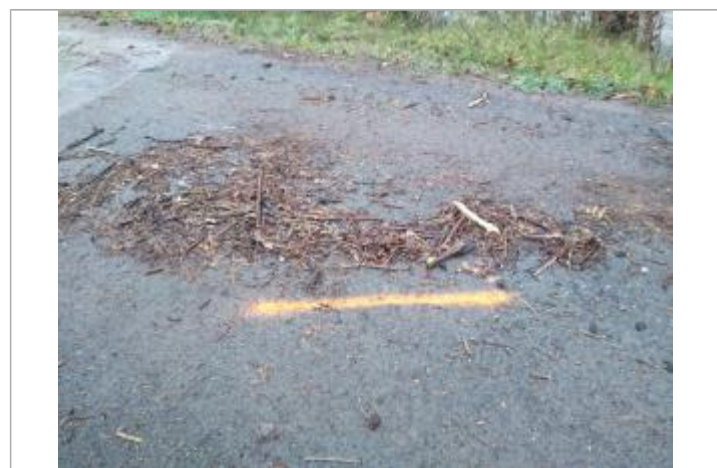
Dépôt sur la chaussée
