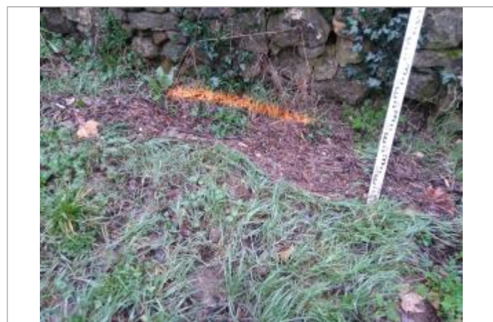
Dépôt au pied du mur
