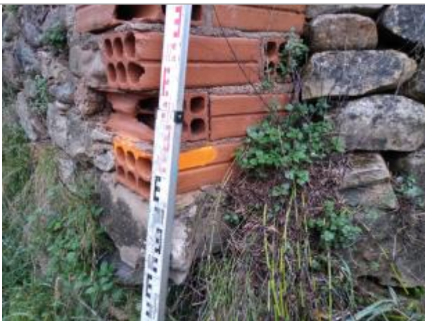
Débris végétaux accrochés au mur
