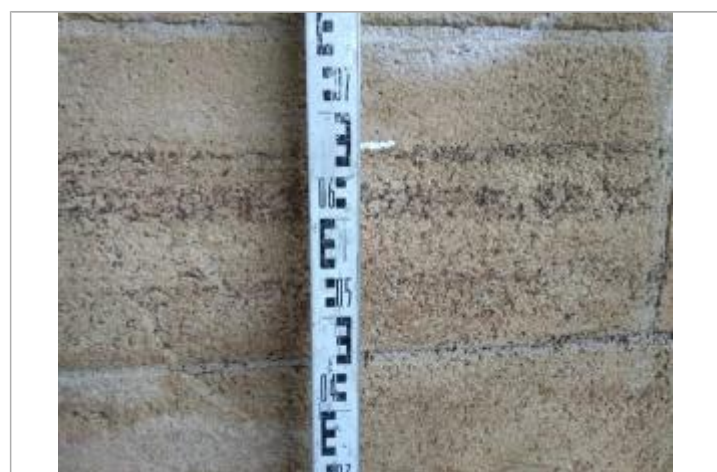
Trace sur la culée
