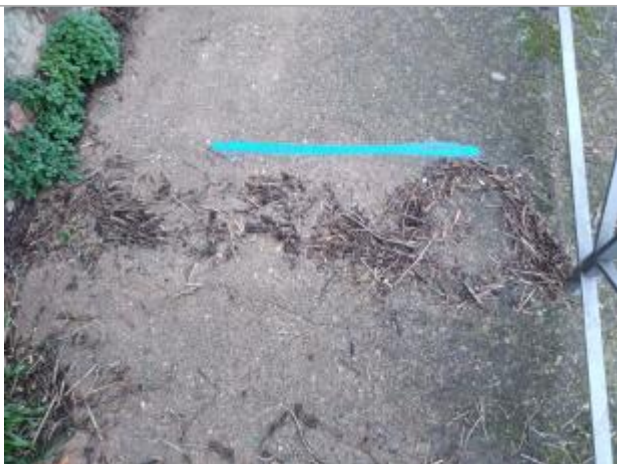
Dépôt sur la rampe
