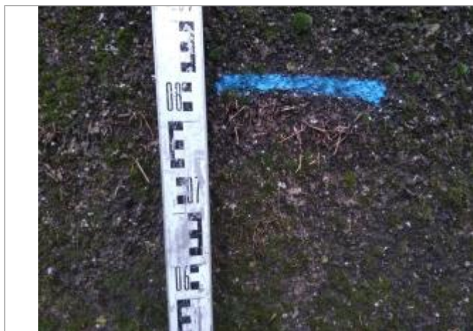
Trace sur le mur
