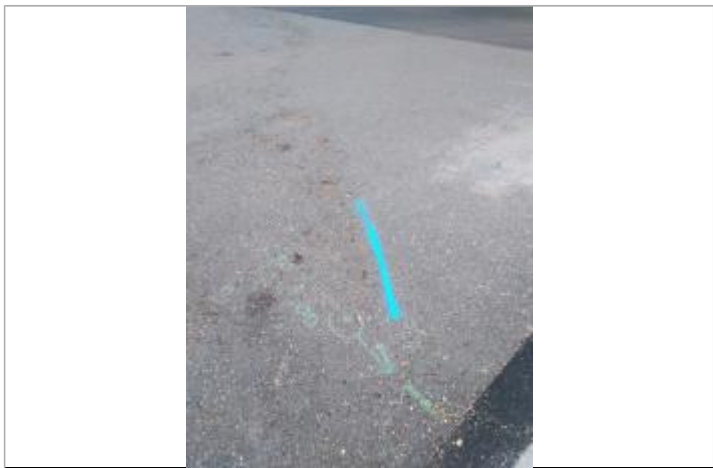
Dépôt sur la chaussée
