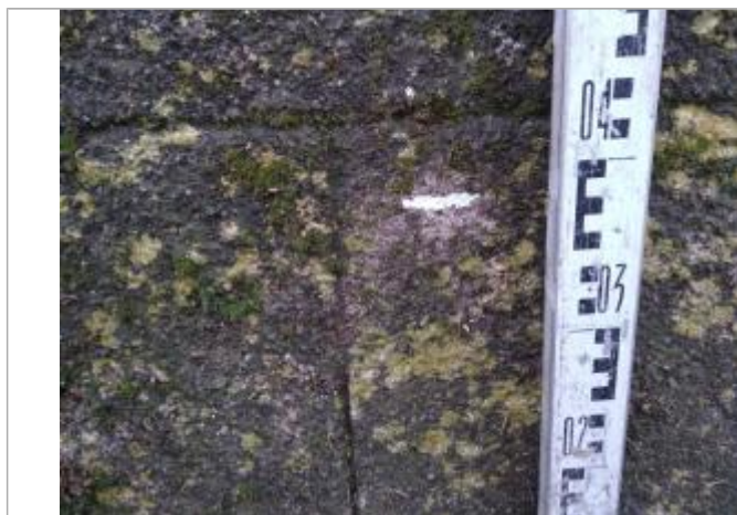
Trace sur le mur
