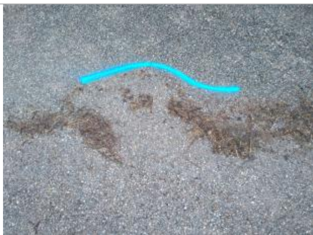
Dépôt sur la chaussée
