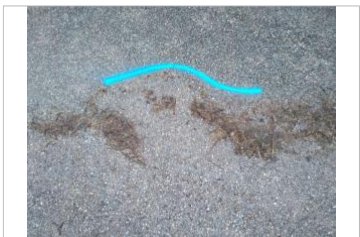
Dépôt sur la chaussée
