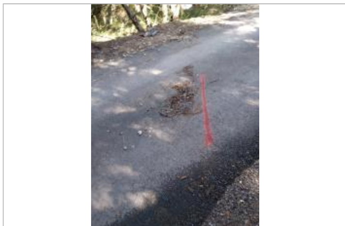
Dépôt sur la chaussée
