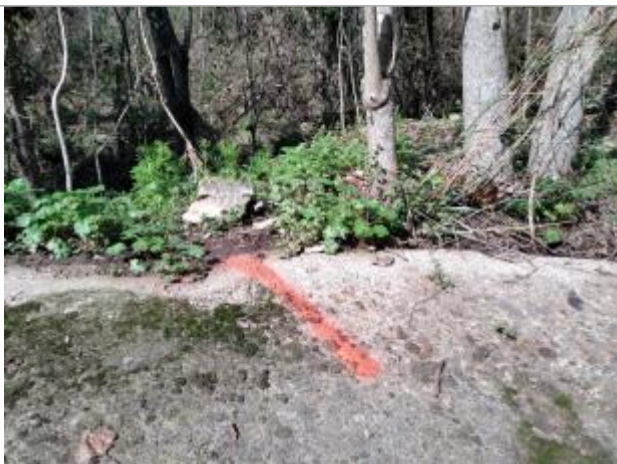
Dépôt en bord de chemin, reporté sur le béton
