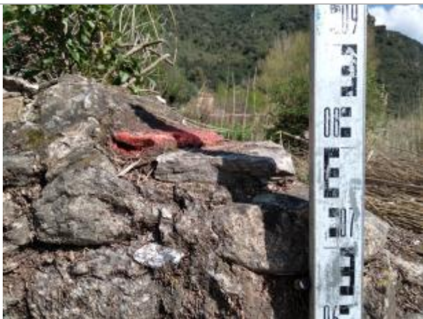
Trace sur le mur
