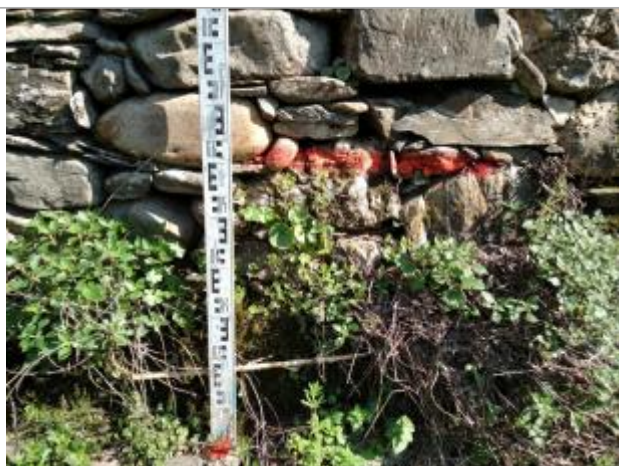
Trace sur le mur
